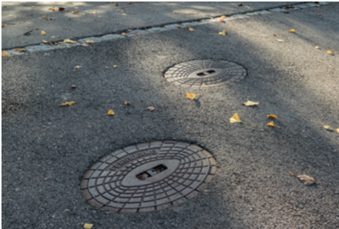
Deckel für Fernwärme gibt es in Uetikon seit 2014
