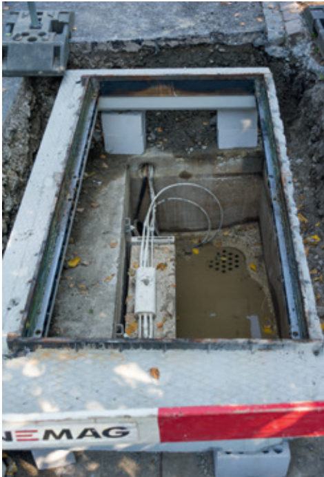
Im Winter 2020 verlegte die Swisscom in weiten Teilen der Gemeinde moderne Glasfaserkabel
