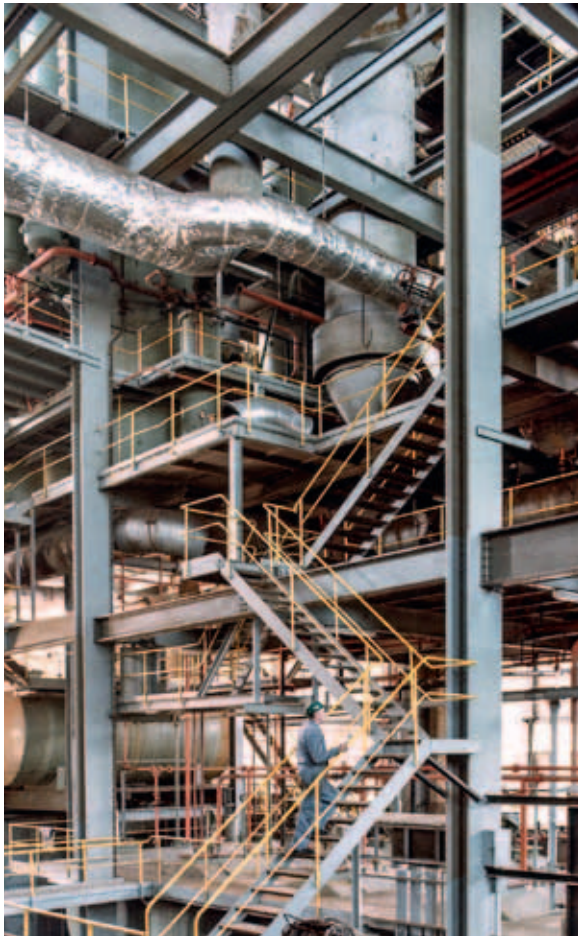
Die Anlage in Full produzierte von Anfang an nach dem modernen Kontaktverfahren
