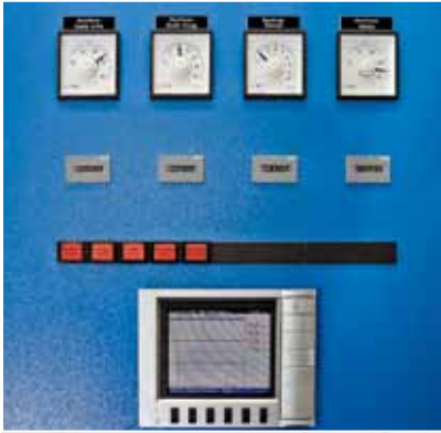
Steuerung und Registrierung Sammelbrunnenstube
